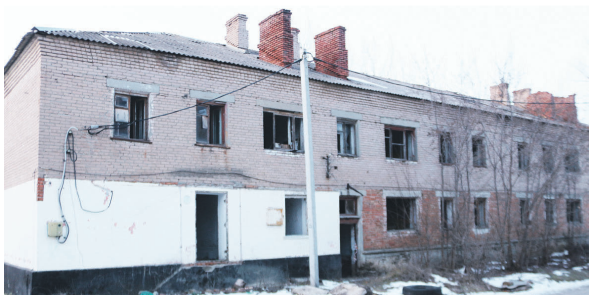
Опустевший аварийный дом по пер. Матросова, 11, по данным Администрации Углегорского поселения, должны снести в первом квартале 2024 года. Фото автора
